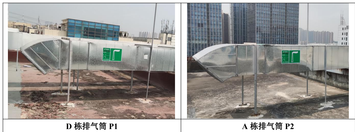
图 3-2 废气收集设施、排放口现状图片
